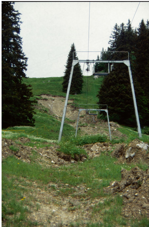
Abb. 4.20 Beispiel für eine Destabilisierung nach einer Baumaßnahme und die Folgen nach einem Starkregenereignis bei fehlenden Wasserausleitungen. Abgang einer Mure auf einem ehemaligen Kabelgraben für eine Abwasserleitung in sensiblen geologischem Untergrund (Skigebiet Wendelstein). (U. Pröbstl-Haider)
