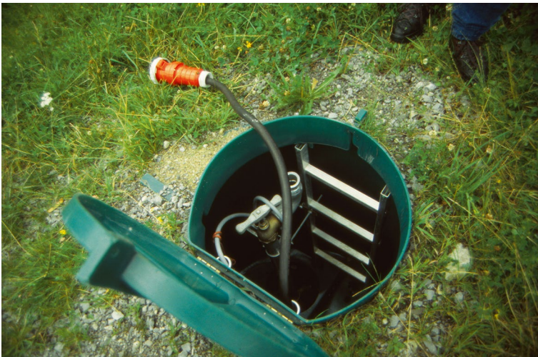
Abb. 3.9 Einblick in einen begehbaren Unterflurhydranten. (U. Pröbstl-Haider)
