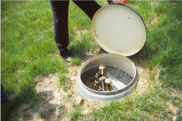
Abb. 3.8 Unterflurhydrant bei Hochdruckanlage. (U. Pröbstl-Haider)
