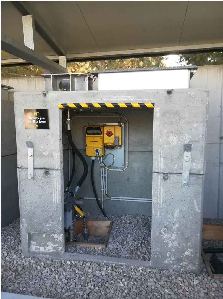
Abb. 3.10 Unterflurschneischacht mit technischem Innenleben. (C. Weiler)
