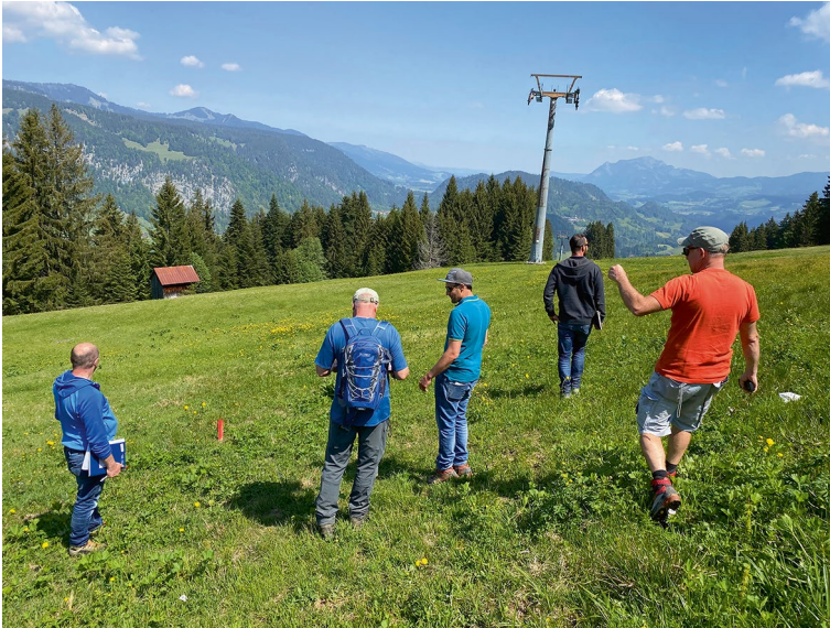
Abb. 5.3 Gemeinsame Feintrassierung von Leitungsraben und Standorten der Zapfstellen durch Fachplaner, ökologische und geologische Bauaufsicht sowie die Bauleitung der beauftragten Baufirma. (C. Weiler)
