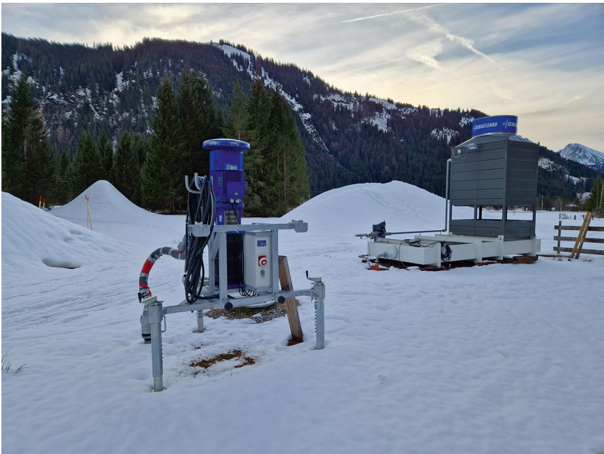
Abb. 3.17 Mobile Pumpanlage und mobile Kühlturmanlage. (C. Weiler)
