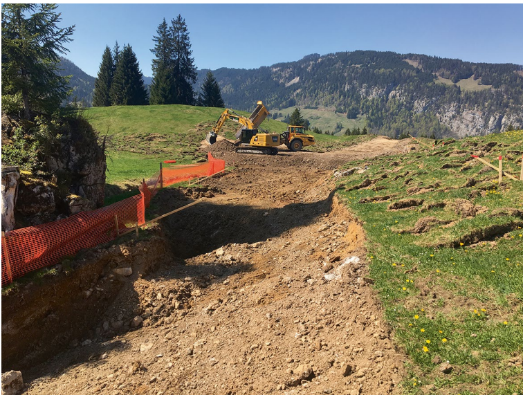
Abb. 5.7 Abzäunung wertvoller Bereiche im Vorfeld der Umsetzung. Rasensoden für den Wiedereinbau vor Ort werden seitlich gelagert, (C. Weiler)
