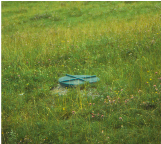
Abb. 5.11 Durch Verwendung von Unterflurhydranten und deren farbliche Gestaltung lassen sich negative Auswirkungen auf das Landschaftsbild im Sommer reduzieren (Beispiel Sudelfeld). (U. Pröbstl-Haider)
