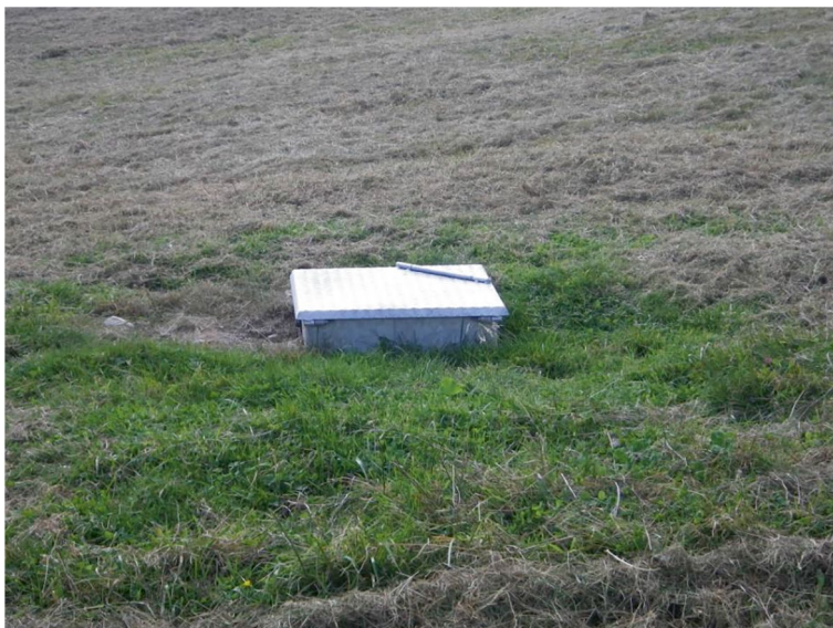
Abb. 3.6 Begehbarer Unterflurhydrat (C.Weiler)
