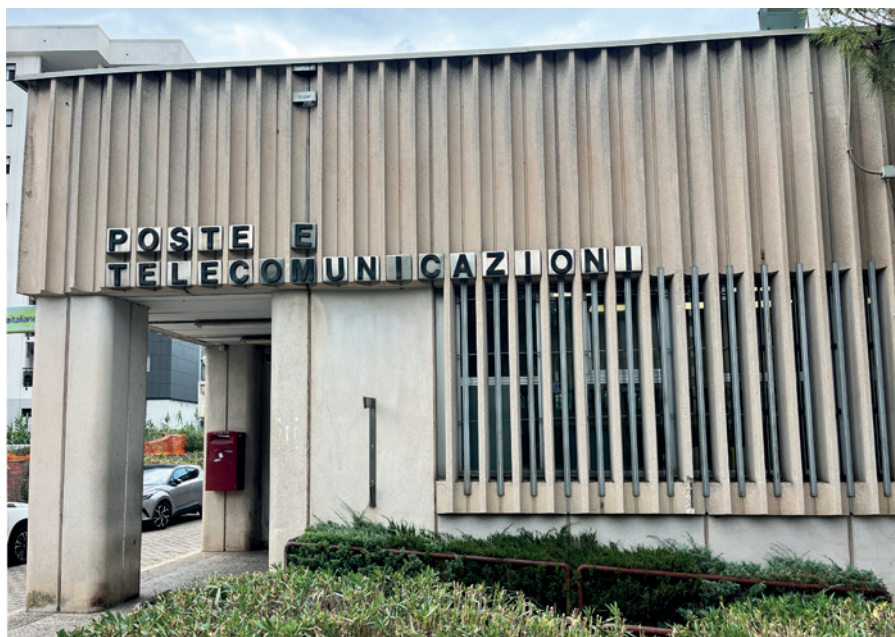
Figg. 23,24 - Ufficio di Rende (CS) 2025. Si nota l'inserimento di profili metallici nei pannelli posti davanti alle aperture
