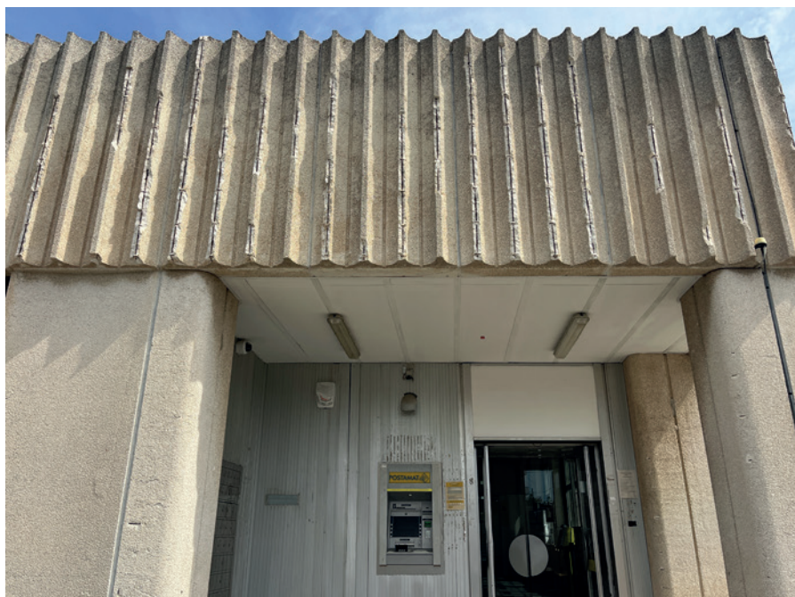
Figg. 16,17 - Il degrado dell'involucro interessa in particolare i pannelli superiori
