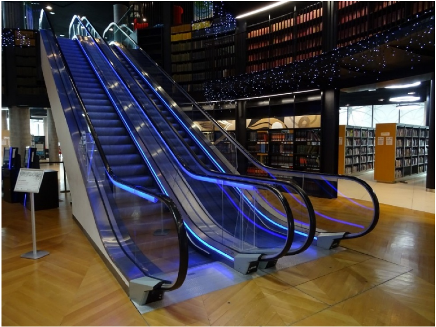
Abb. 11: Rolltreppen in der Library of Birmingham
